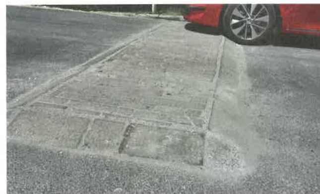
■ BETONBA ÁGYAZOTT TÉRKŐ BURKOLAT MEREDEK FELHAJTÓVAL – Egy-egy találkozás komoly károkat okozhat a gépjármű felülgesztésében is...
